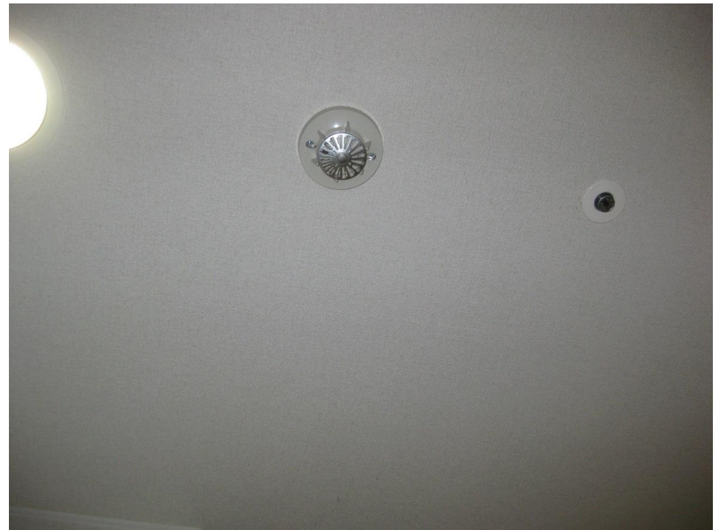
天井(スプリンクラー)
